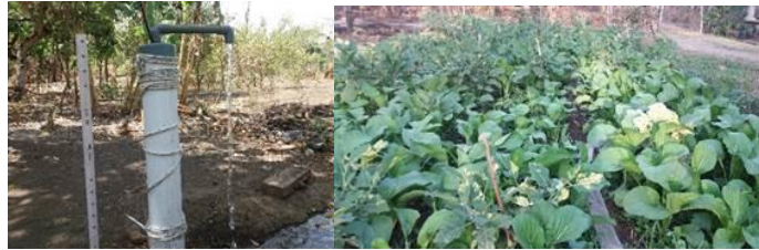
Gambar 21. Implementasi system pembangkit listrik untuk Pompa Air Pengairan sayur
