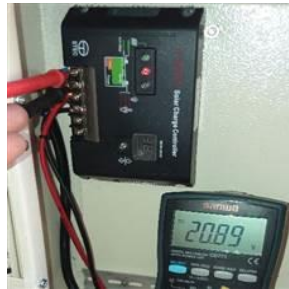
Gambar 16. pengecekan tegangan pada SCC dari solar cell
