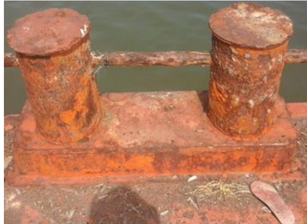
Gambar 1. Dudukan tali kapal yang terkorosi
