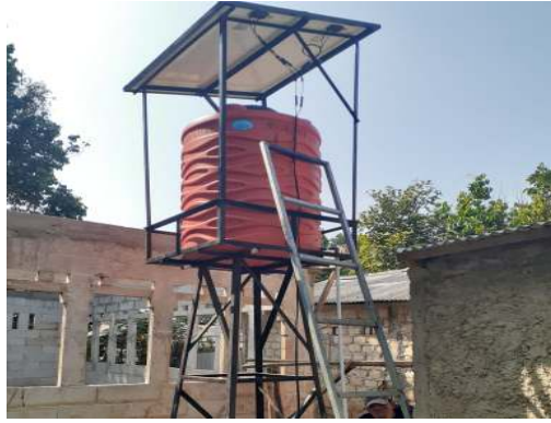
Gambar 5 Panel Surya yang telah terpasang Hasil Pembangunan Pembangkit
