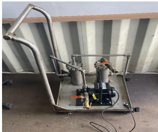
Gambar 6. Pompa filtrasi skid
